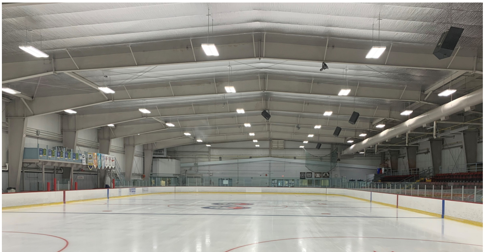
Le nouvel éclairage de l'aréna de la BFC Bagotville maintenant entièrement au DEL offre davantage de lumière pour une consommation d'électricité considérablement réduite.
